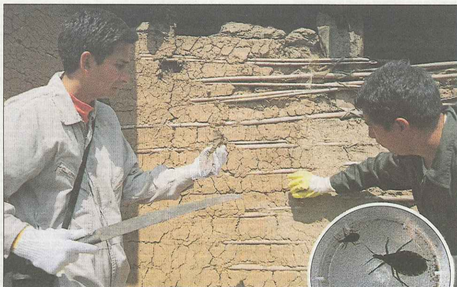
Miembros de MSF buscan vinchucas en las grietas de una vivienda en Bolivia. A la derecha, la chinche transmisora.
